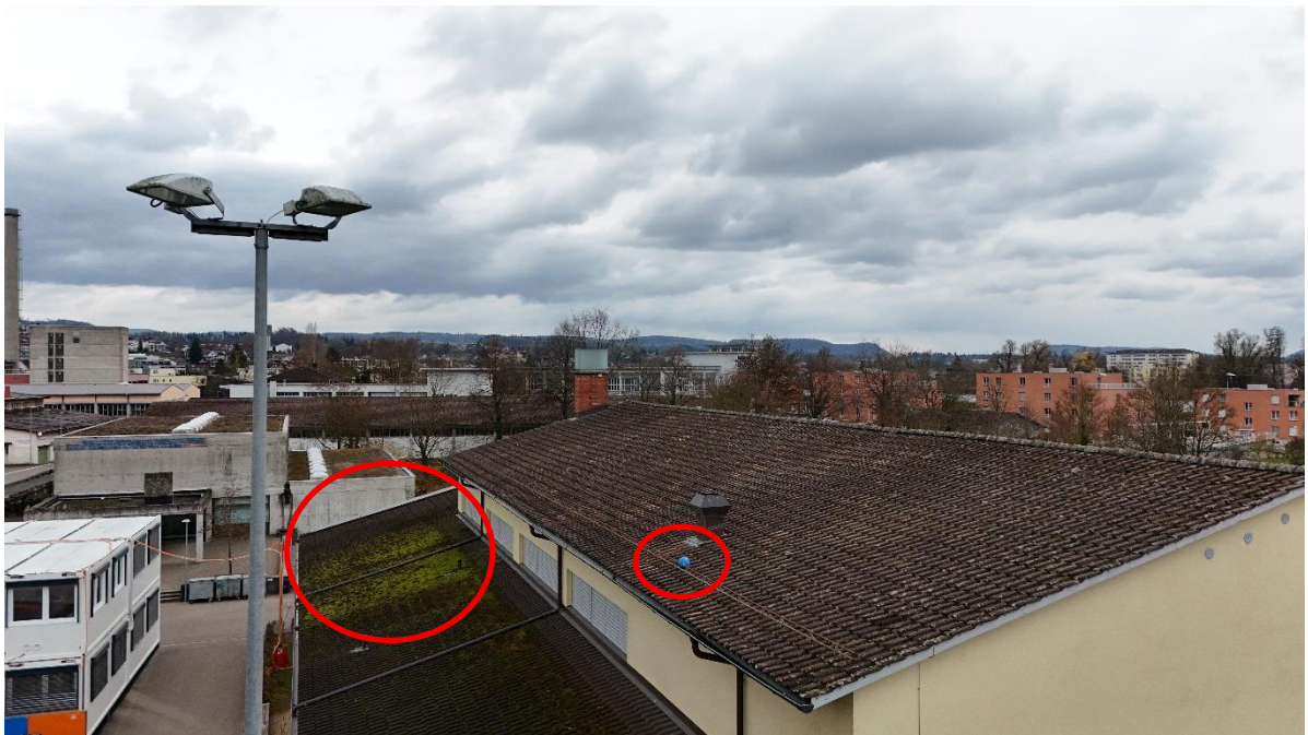
Moosbefall und Spielzeug auf dem Dach
