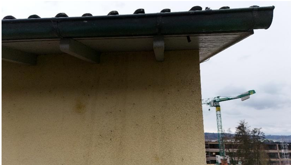
Wasserläufe an der Fassade.
